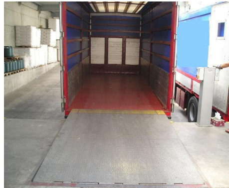
banchina di carico con rampa elettroidraulica
